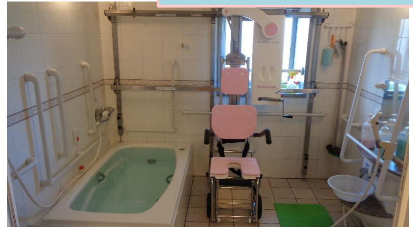
一般大浴室（リフト浴）
